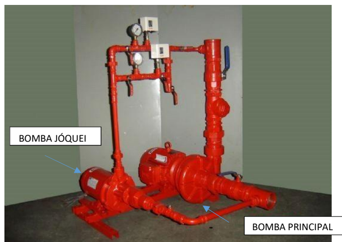
Sistema de Bombas
